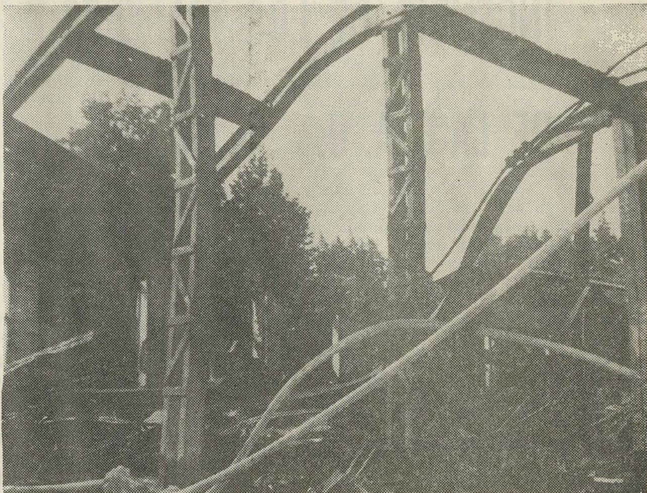
TALLERES DE LA ESCUELA DE ARTES Y OFICIOS DESPUES DEL INCENDIO
